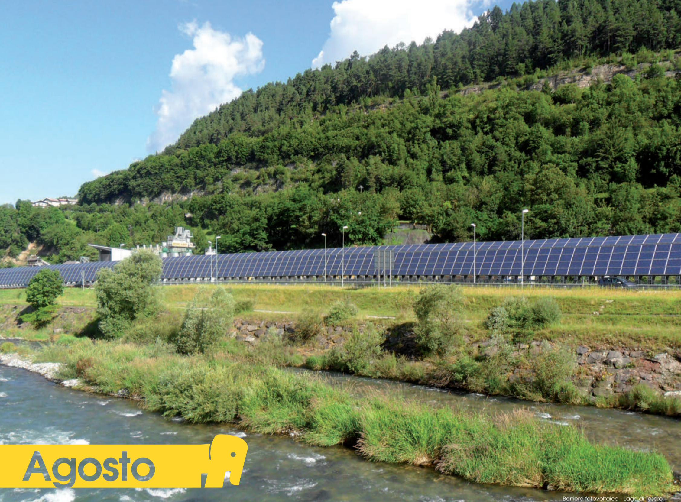
Barriera fotovoltaica - Lago di Tesero
